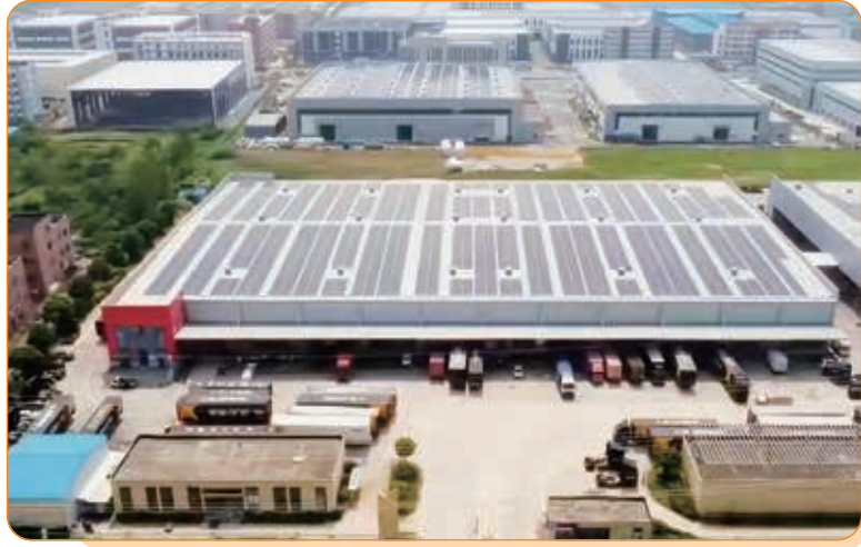
園區光伏發電板
